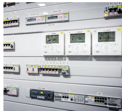
Řídicí systém Daikin byl jednoduše připojen k řídicímu systému budovy.
