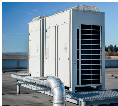
Venkovní jednotky VRV IV jsou vybaveny technologií proměnlivé teploty chladiva a to zvyšuje efektivitu.
