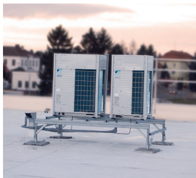
Kompaktní venkovní VRV IV jednotky jsou instalované na střeše obchodu.
