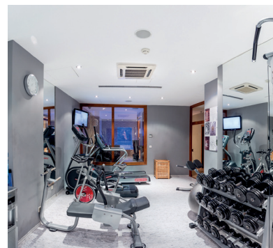
VRV umožňuje nezávislé řízení různých prostorů hotelu: od pokojů, přes lobby až po posilovnu.
