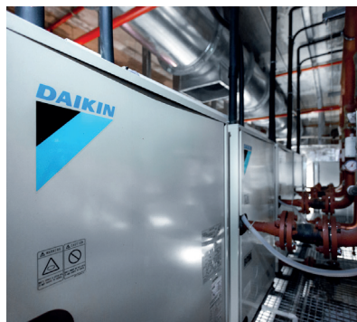
Jednotky VRV W jsou napojeny na vodou chlazený systém nákupního centra.
