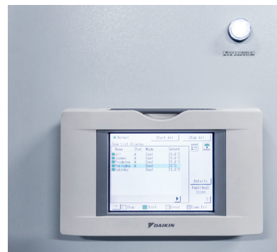
Daikin Intelligent Touch Manager řídí systém zevnitř jednotky a je napojen na řídicí systém nákupního centra.
