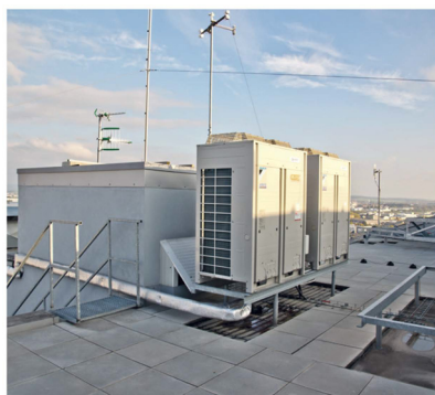
Kompaktní venkovní VRV jednotky jsou umístěny na střeše budovy.
