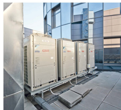
22 venkovních jednotek VRV obsluhuje více než 320 vnitřních kazet v 18 patrové budově.
